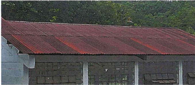
Foto 1: Se observa el deterioro y están totalmente oxidadas de las láminas de las tres aula.
