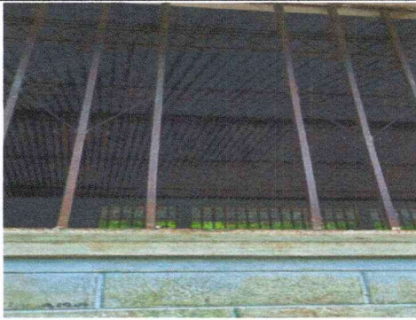
Foto 3: se observa las malas condiciones de los balcones del centro educativo.
