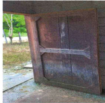
Foto 4: se necesita cambio de una puerta de madera a metal.
