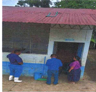
Foto 2: se observa el mal estado, de las láminas de la Dirección.
